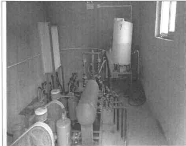
污水处理设施
