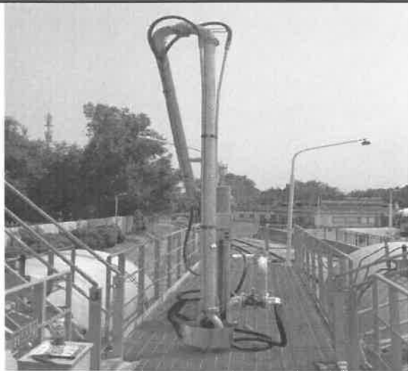
卸油区密闭管线、管件
