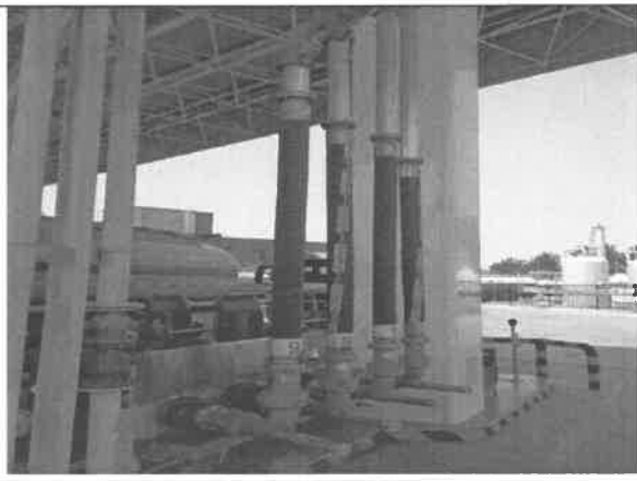
发油区密闭管线、管件
