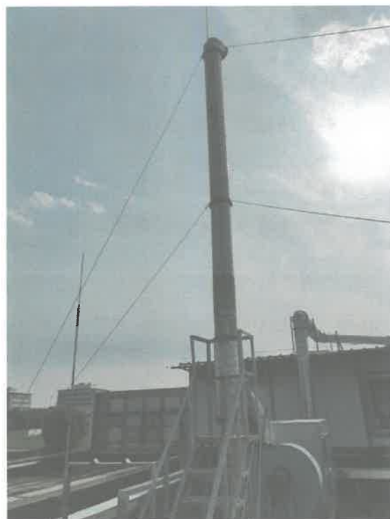
原有胶清洗站排气筒 DA009
