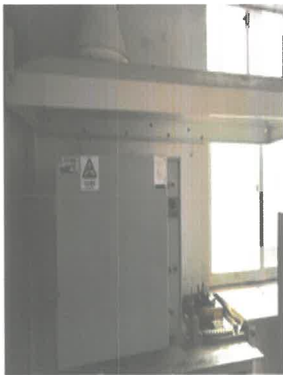
胶清洗站原有废气活性炭净化设备
