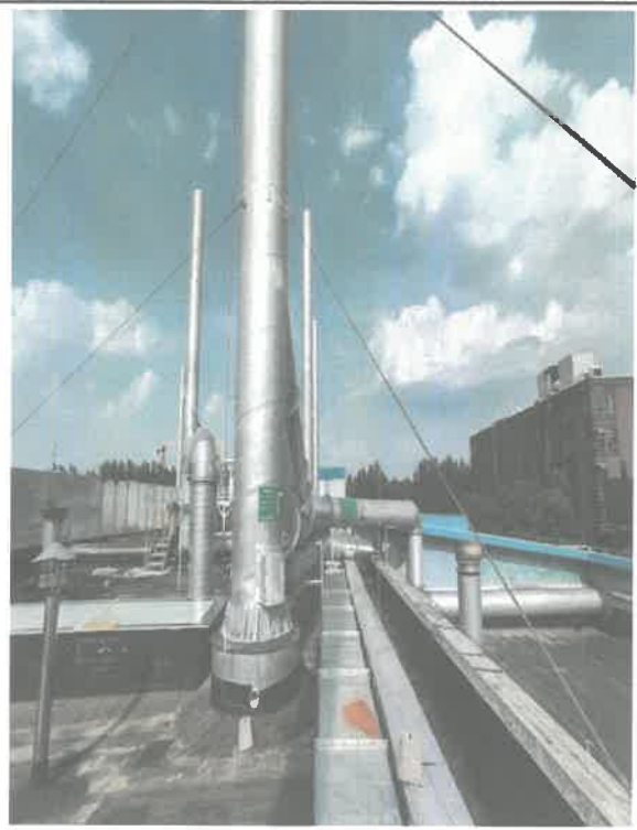
原有打包机排气筒 DA005
