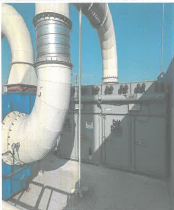
BJ14 新建除尘装置
