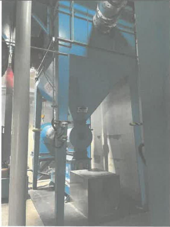
废料打包机原有除尘器
