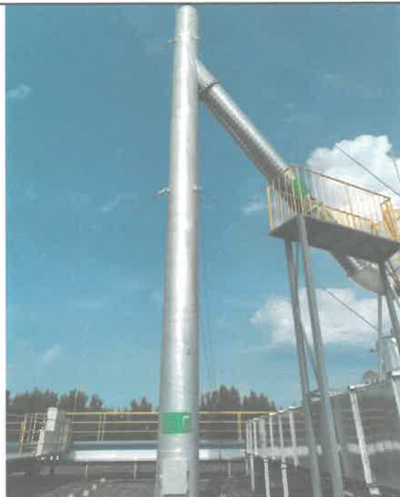
BJ14 新建含尘废气排放口 DA010
